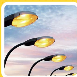
REDE ELÉTRICA E ILUMINAÇÃO PÚBLICA
